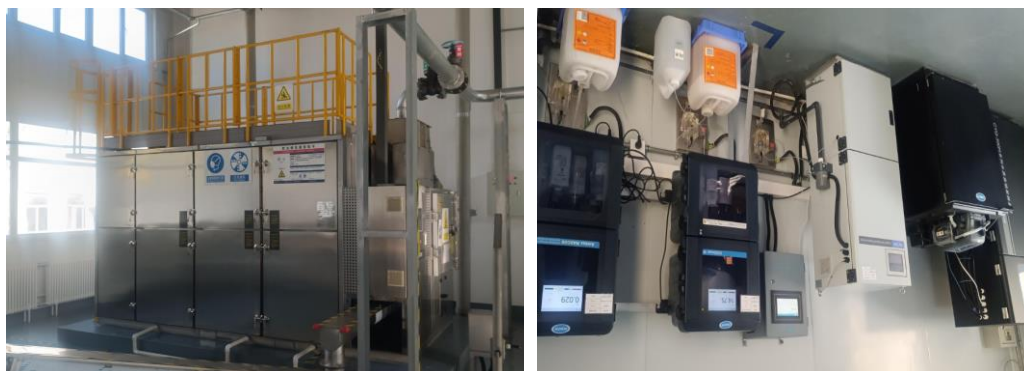
污水厂污泥干化设备
