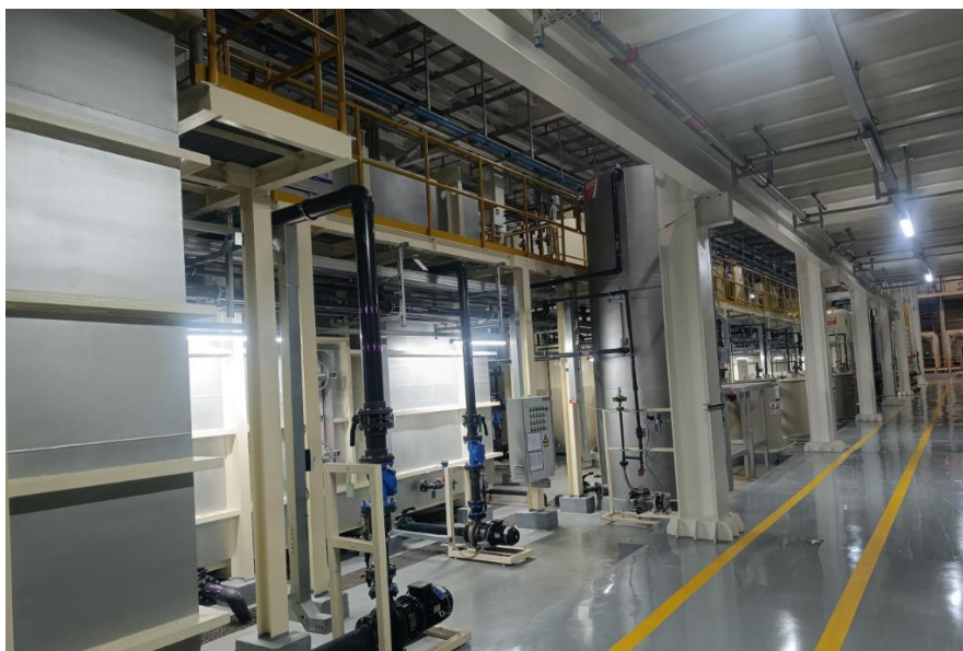
图 5.1-2 车身涂装废水处理系统照片
