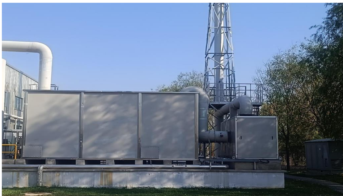
污水站臭气治理设备（生物过滤）
