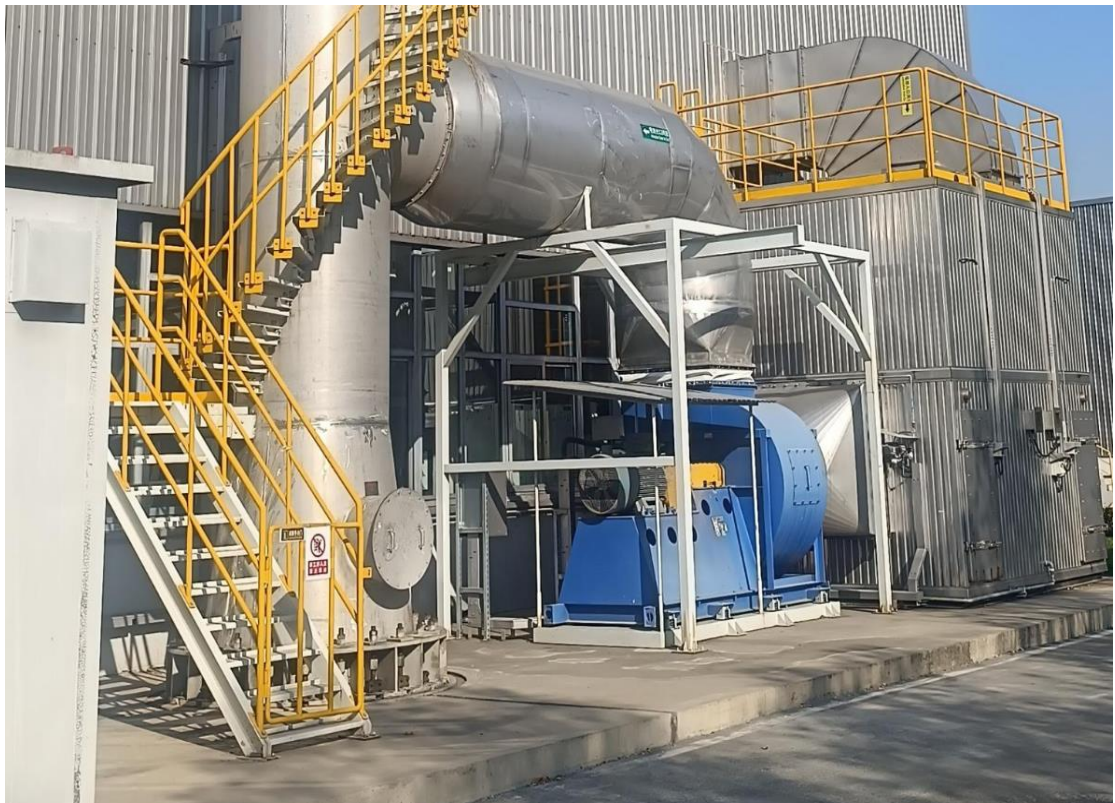
塑料件点修补废气治理设备（活性炭吸附）
