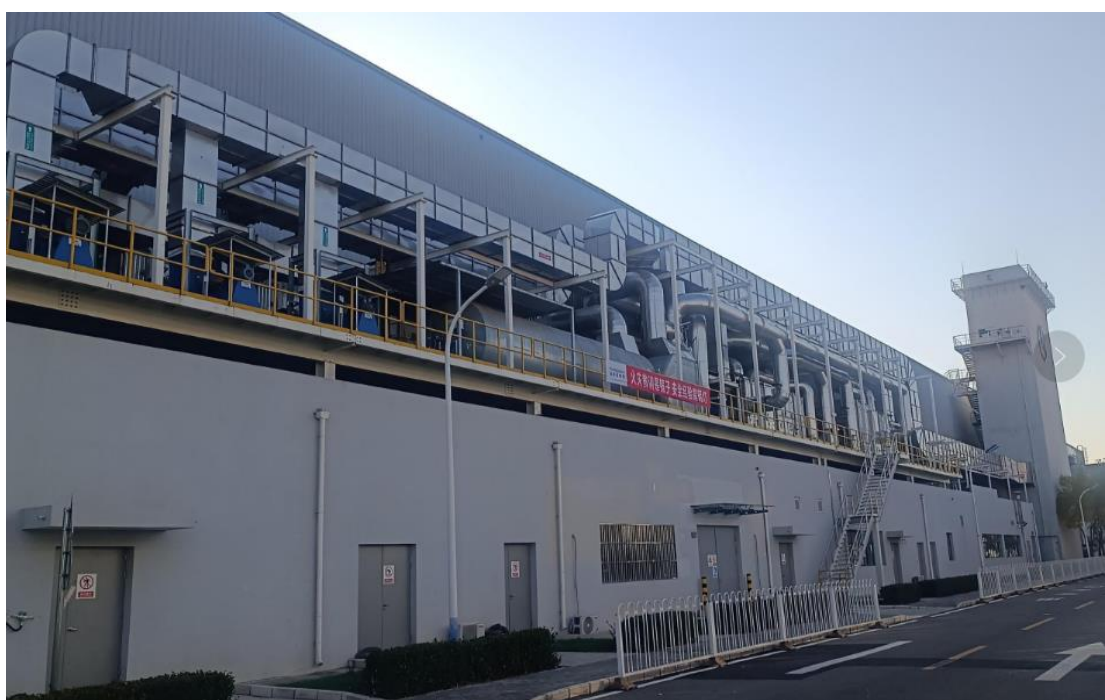
车身喷漆废气治理设备（沸石转轮+RTO）
