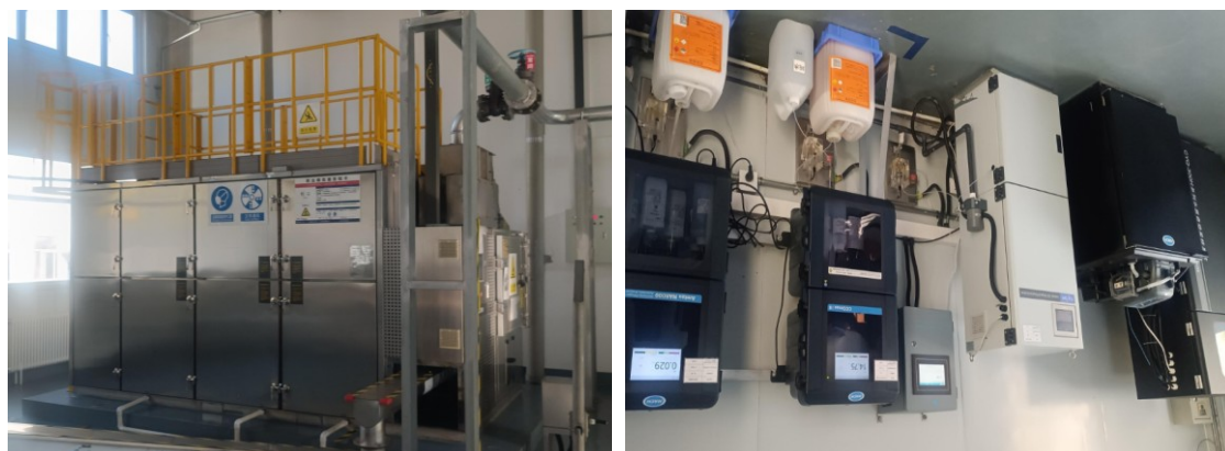
污水厂污泥干化设备
