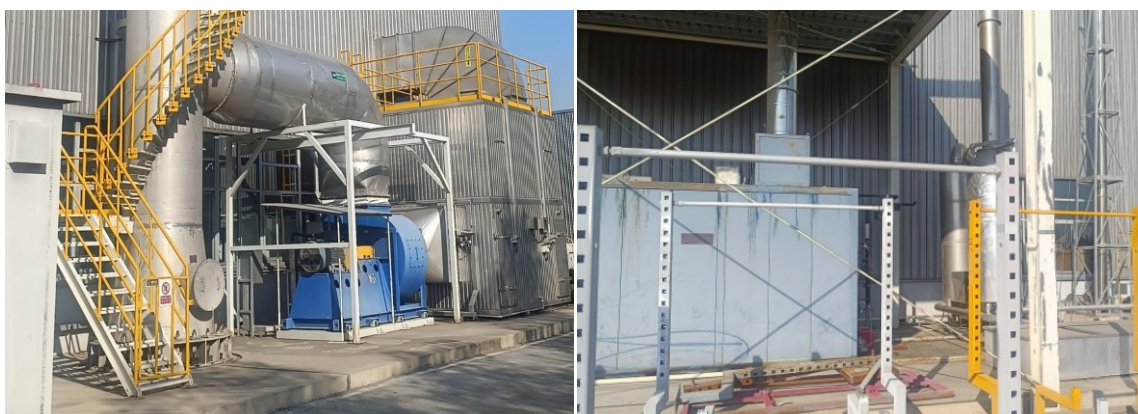
底盘下线补漆废气活性炭吸附装置
