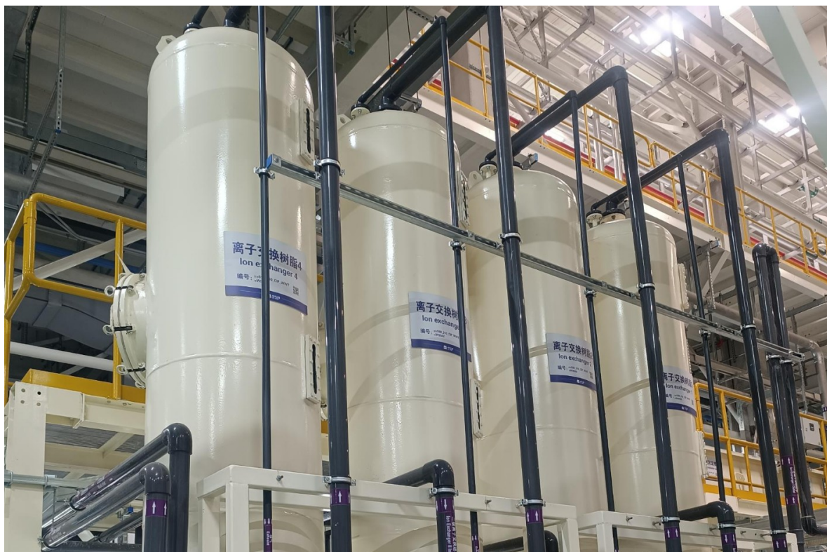
图3.9-1 磷化含镍废水预处理系统（离子交换树脂）
